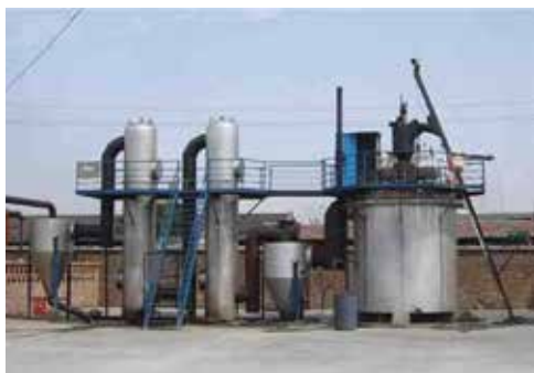
图3-2-3 工业燃煤气化炉
